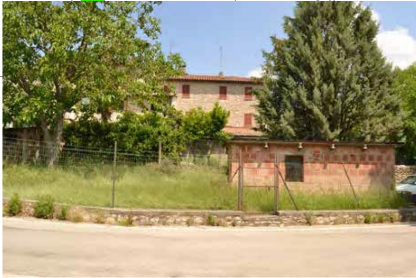
2 - Edificio privato, fortemente degradato
