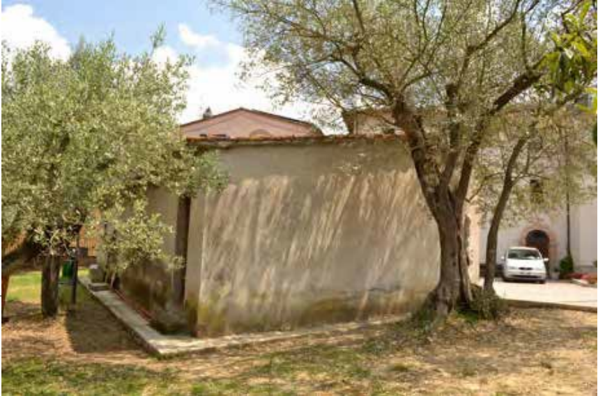
2 - Edificio privato, in stato di degrado
