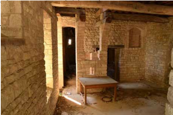
1- Edificio privato, inutilizzato fortemente degradato
