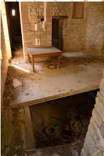
1- Edificio privato, inutilizzato fortemente degradato
