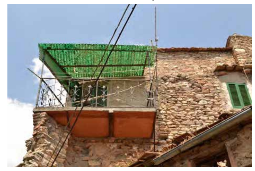
3 - Edificio demaniale fortemente degradato
